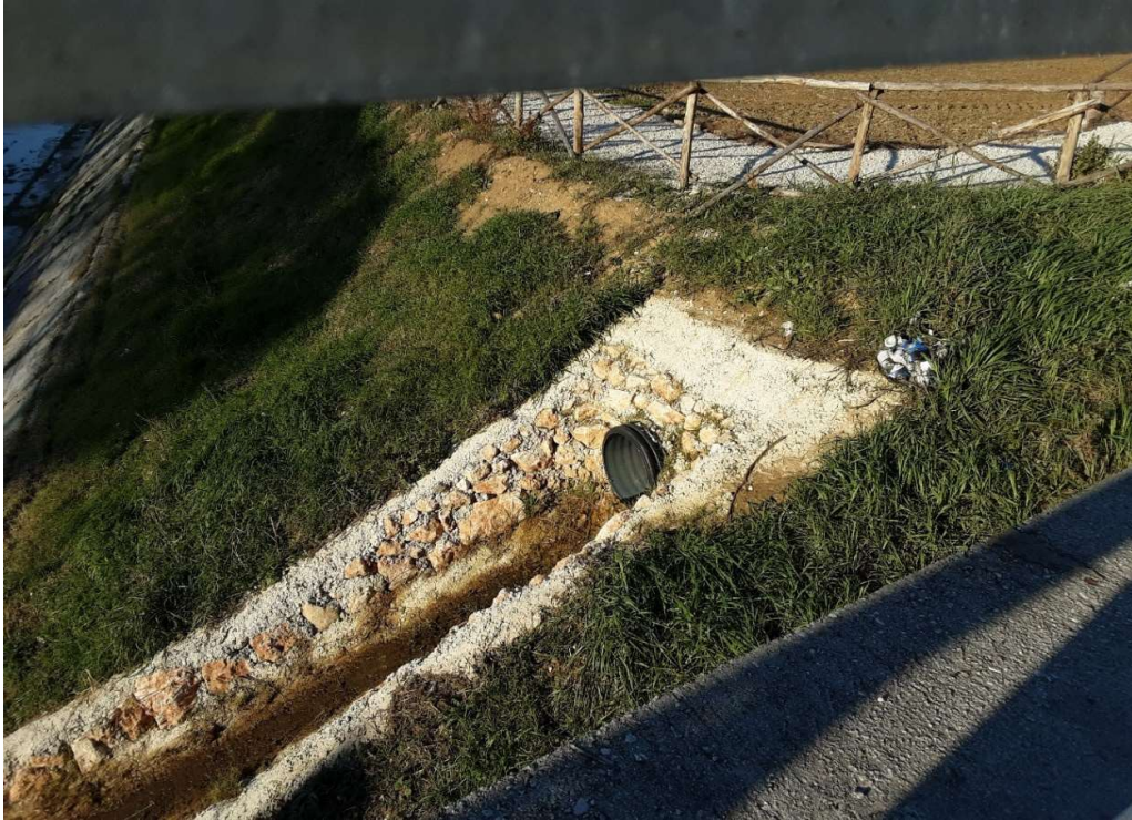
Figura 3.1 Condotta lato Rimini
